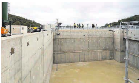
Instalaciones de la depuradora de sa Coma. | TONI ESCOBAR
