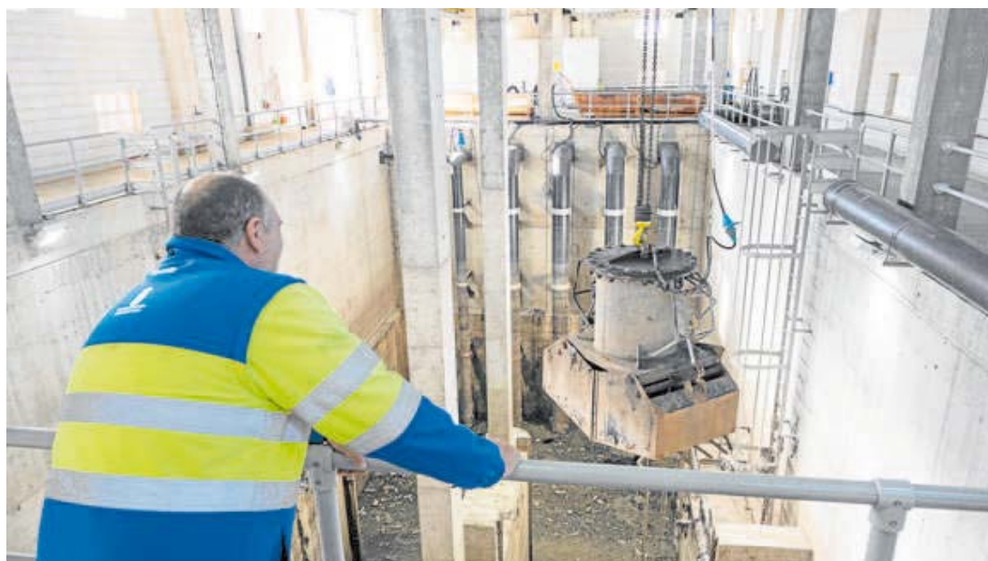
David, de Aqualia, en la zona de recepción del tanque de tormenta, donde se ve la máquina 'cuchara' que sirve para recoger los desechos. J. V. ARNELAS
